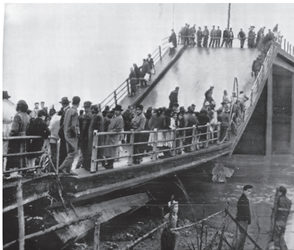
Puente Carretero sobre el río Biobío, parcialmente destruido en el terremoto de 21 de mayo de 1960.
